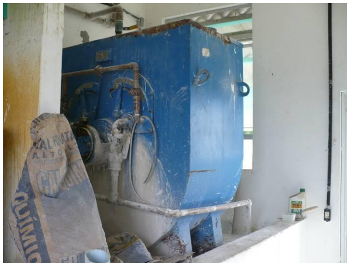
Figura 17: Tanque de preparação da cal hidratada - correção do pH. Fonte: Visita Técnica STE.
