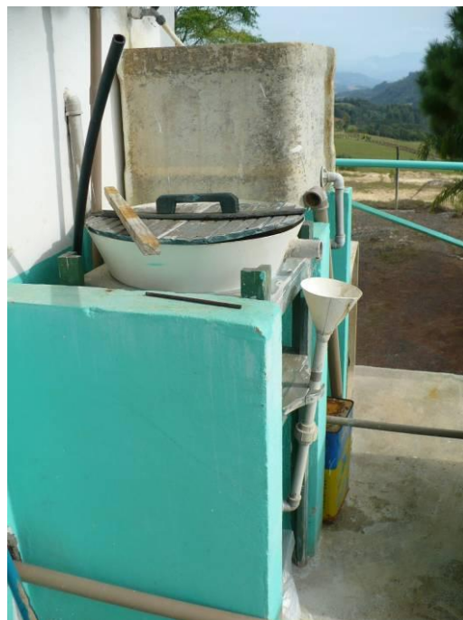
Figura 15: Dosagem de fluor. Fonte: Visita Técnica STE.
