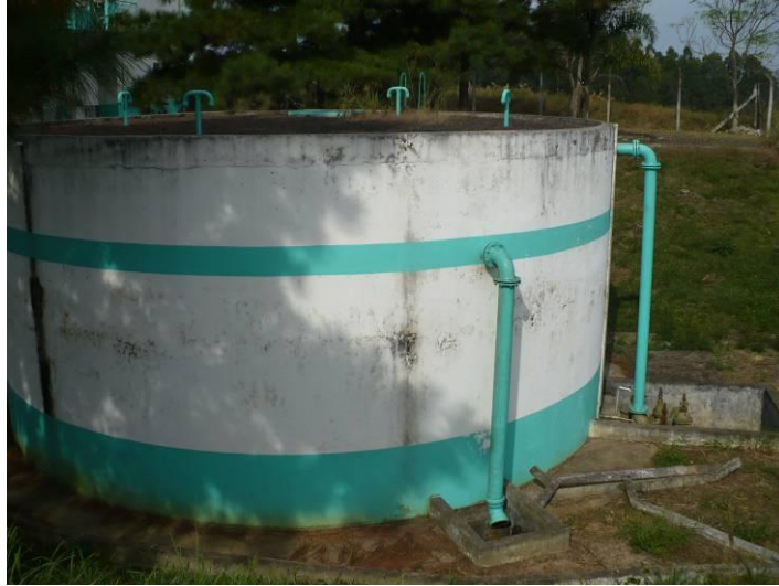
Figura 22: Reservatório junto a ETA (200 m 3 ). Fonte: Visita Técnica STE.
