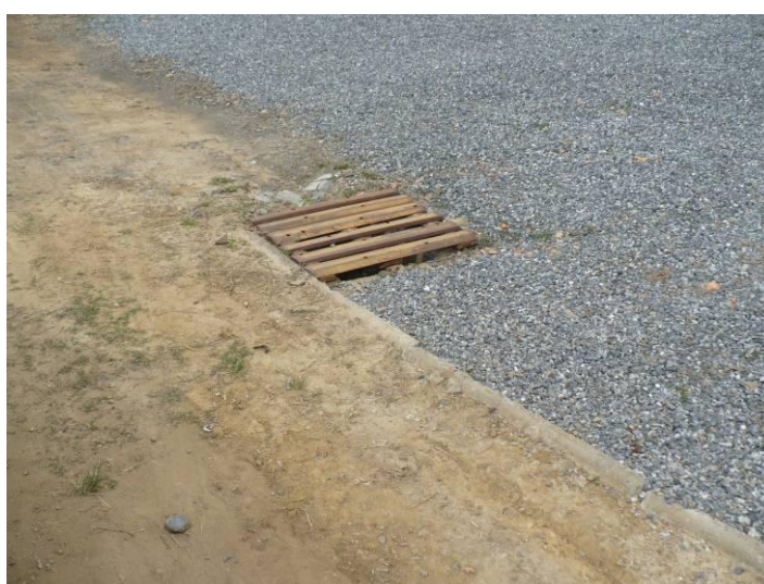
Figura 55: Boca de Lobo tipo grelha – em rua sem pavimentação. Fonte: Visita Técnica STE.
