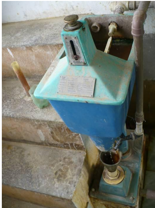
Figura 11: Dosador de sulfato de alumínio ferroso. Fonte: Visita Técnica STE.
