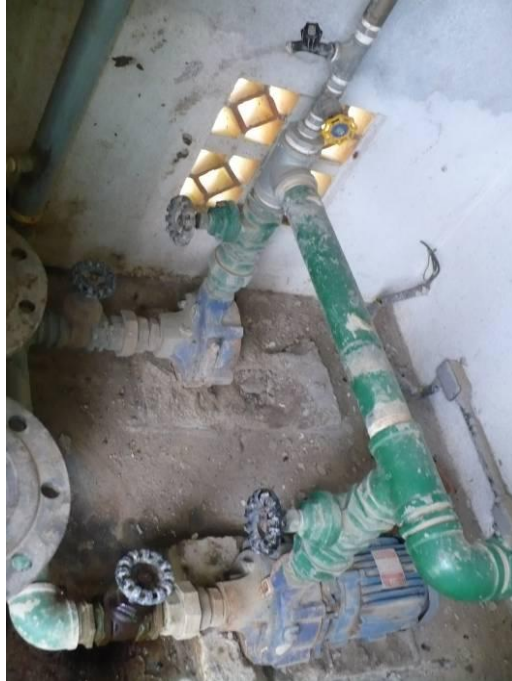
Figura 24: Booster localizado em ponto da rede de distribuição. Fonte: Visita Técnica STE.
