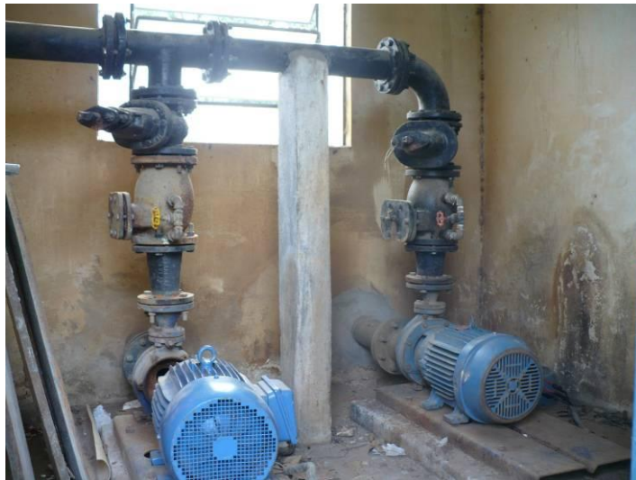
Figura 7: Estação elevatória de água bruta. Fonte: Visita Técnica STE.
