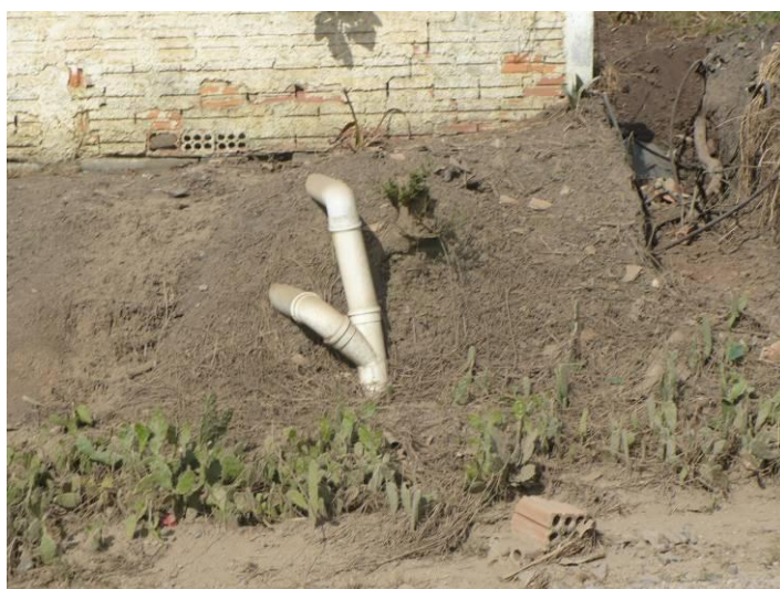
Figura 58: Ligação de Esgoto em rede de drenagem pluvial Fonte: Visita Técnica STE.
