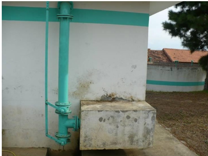
Figura 21: Tubulação para limpeza dos filtros. Fonte: Visita Técnica STE.
