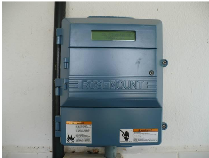
Figura 23: Macro medidor após saída da ETA. Fonte: Visita Técnica STE.
