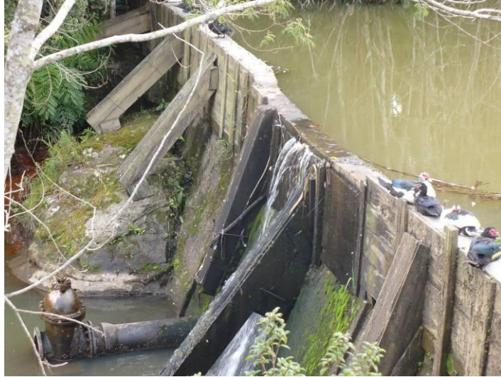
Figura 6: Captação de água bruta - barragem de nível em concreto armado. Fonte: Visita Técnica STE.
