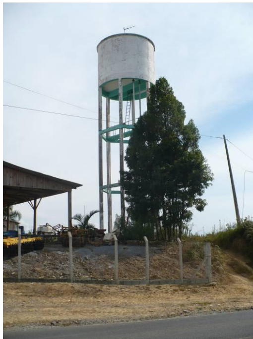
Figura 27: Reservatório elevado (30 m 3 ). Fonte: Visita Técnica STE.
