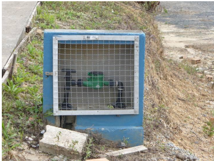
Figura 25: Micro-medidor residencial com Hidrômetro – rede de abastecimento. Fonte: Visita Técnica STE.
