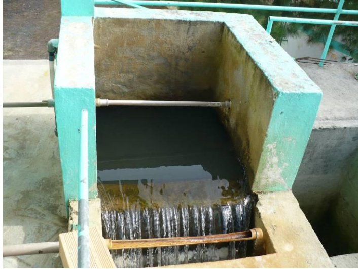
Figura 10: Coagulação – dosagem de sulfato de alumínio ferroso. Fonte: Visita Técnica STE.
