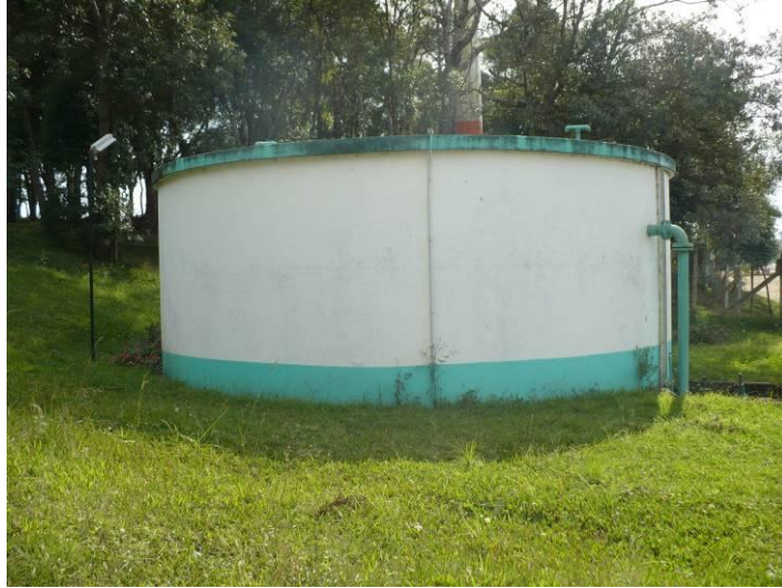
Figura 26: Reservatório desativado (50 m 3 ). Fonte: Visita Técnica STE.
