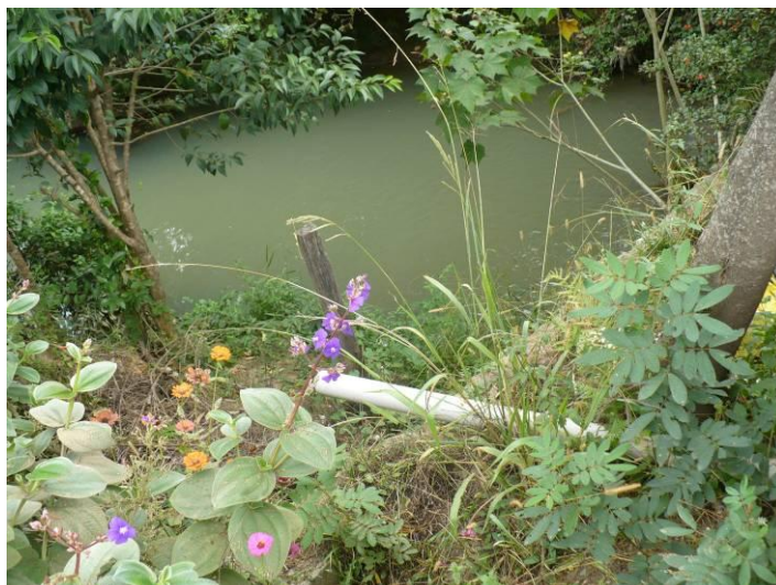
Figura 57: Lançamento de Esgoto diretamente em corpo hídrico. Fonte: Visita Técnica STE.
