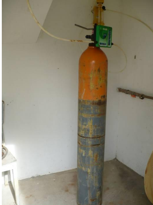
Figura 16: Dosagem de cloro gasoso. Fonte: Visita Técnica STE.
