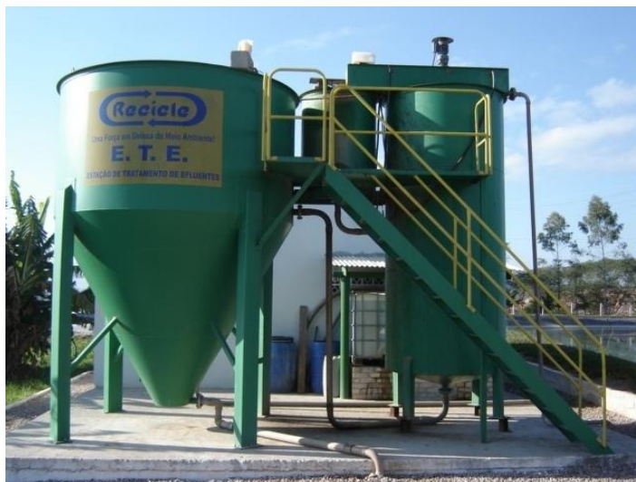
Figura 49: Sistema de tratamento de líquidos percolados. Fonte: RECICLE
