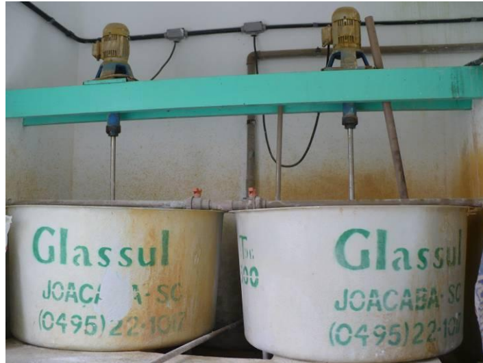
Figura 18: Tanque de preparo da solução de sulfato de alumínio ferroso. Fonte: Visita Técnica STE.
